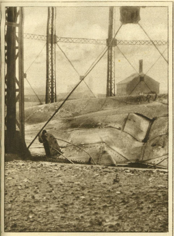
De beschadigde gashouder te Hartlepool.
